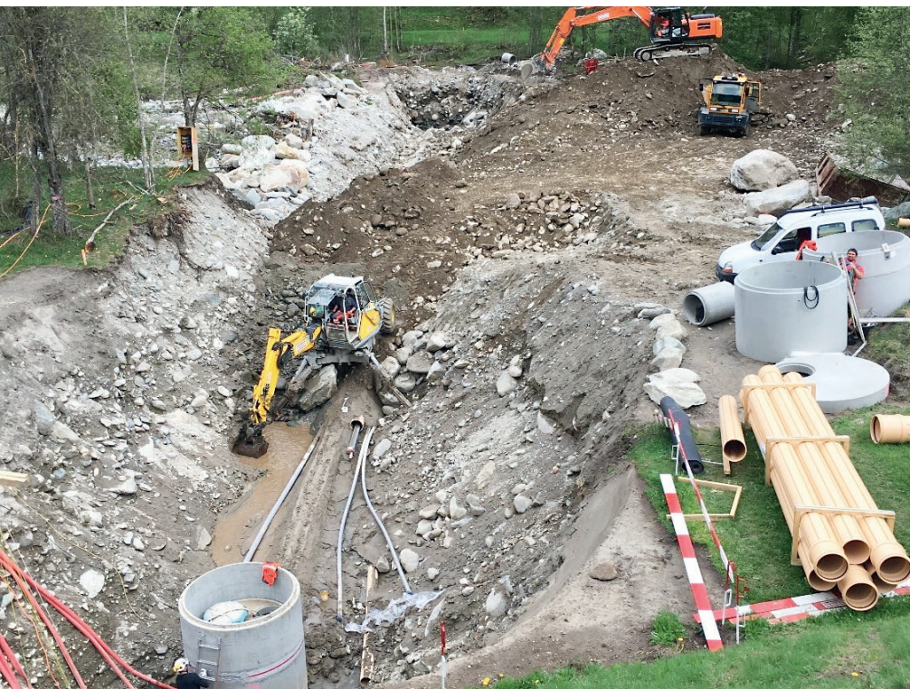
Pumpadis a Plaun Sut dalla canalisaziun Cavardiras
